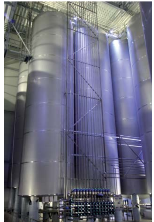
Blick in den neuen Drucktankkeller
